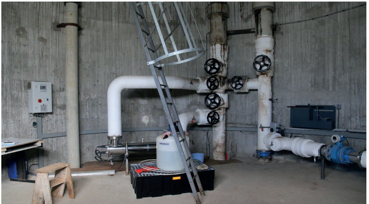
L'arrivée du forage et le traitement UV.
