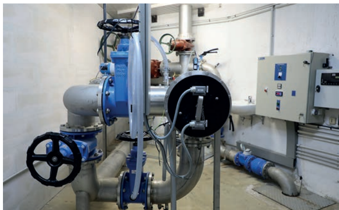
Station de désinfection par les UV.
